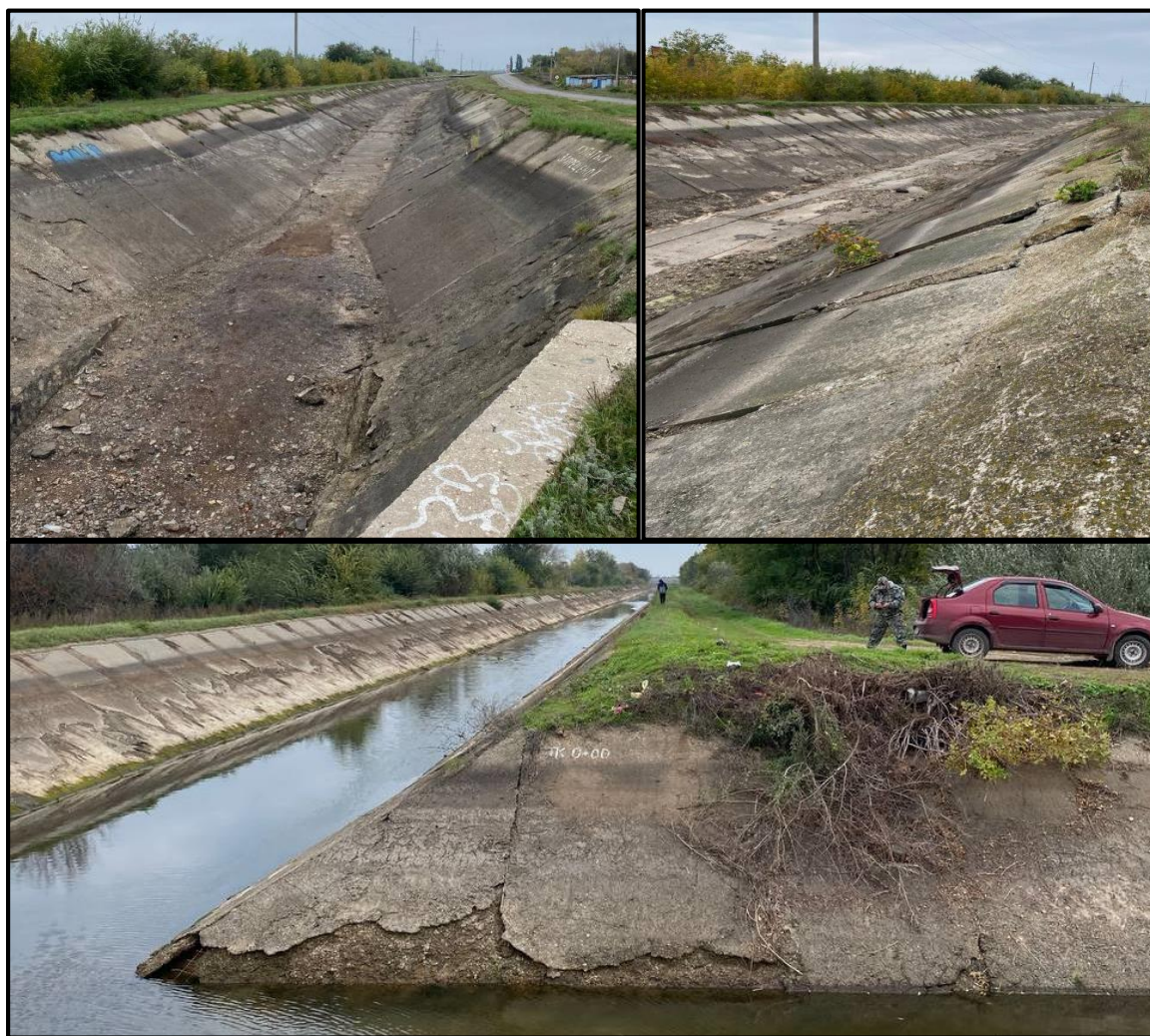
Рисунок 1.8 – Повреждения противофильтрационного покрытия МК 1 Энгельсской оросительной системы
