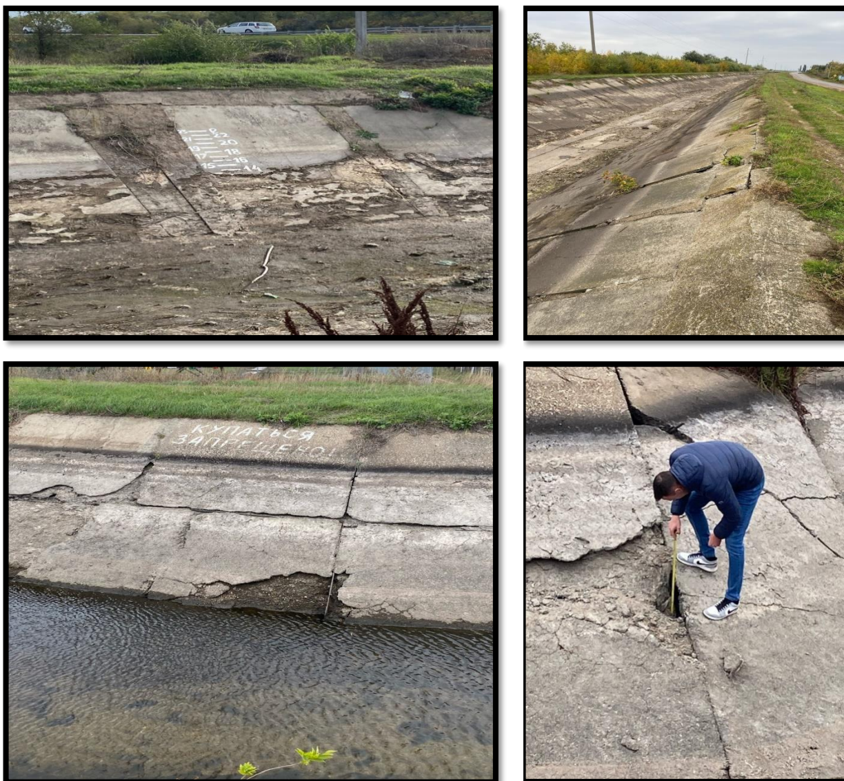
Рисунок 1.2 – Повреждения противофильтрационного покрытия МК 1 Энгельсской оросительной системы
